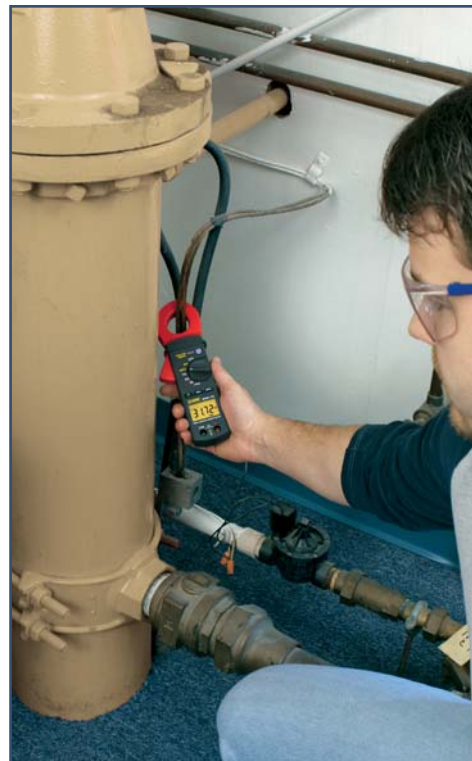
Midiendo la corriente de fuga en un cable de toma de tierra con el Medidor de Corriente de Fugas TRMS Modelo 565
